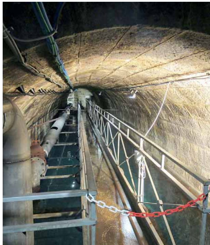
La vasca dell'acquedotto di Pergine: oggi l'acqua diventa preziosa
